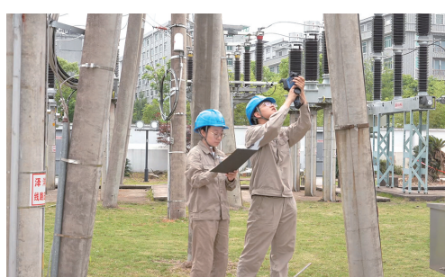
工作人员对设备开展全方位检查。
