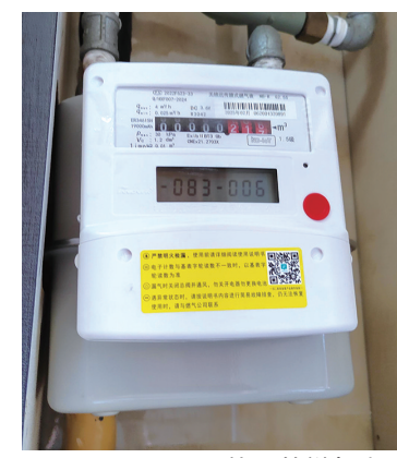
更换后的燃气表。
