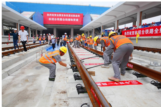
2021年6月22日，杭台高铁在温岭火车站无砟道床上顺利对接最后一对长钢轨，杭台高铁全线铺轨贯通合龙。
