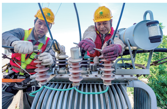
检修设施防台风。
