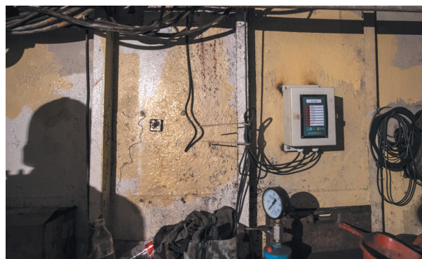
机舱里必须配备报警器，一旦有漏水，就会及时发出警报，提醒上面的渔民。
