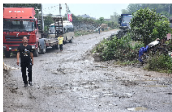
目前的竹盖线金岩段很狭窄，一下雨就坑坑洼洼。
